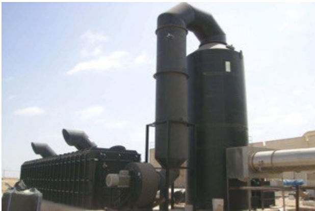
2-х ступенчатая очистка: скруббер + адсорбер
