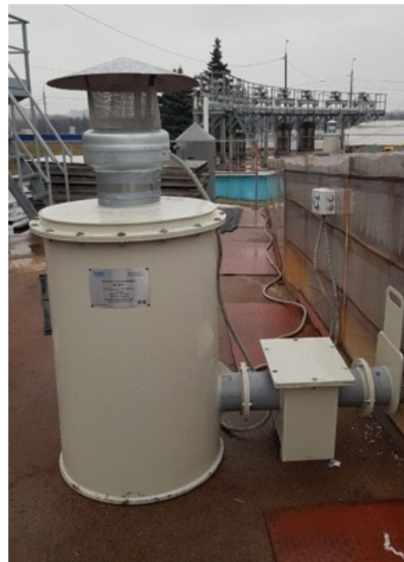
Очистка выбросов от приёмной камеры сточных вод
