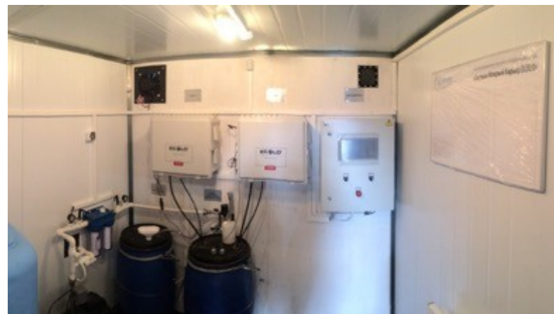
Насосная установка и блок управления АКНЗ
