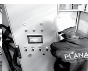
Автоматизированное управление процессом очистки
