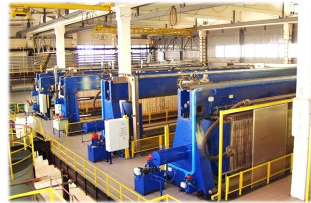
Цех камерных пресс-фильтров
