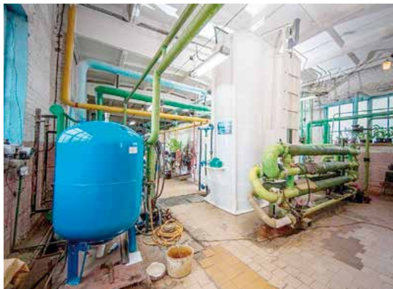
FEKA CLEAN pro-250 в котельной г. Кубинка
